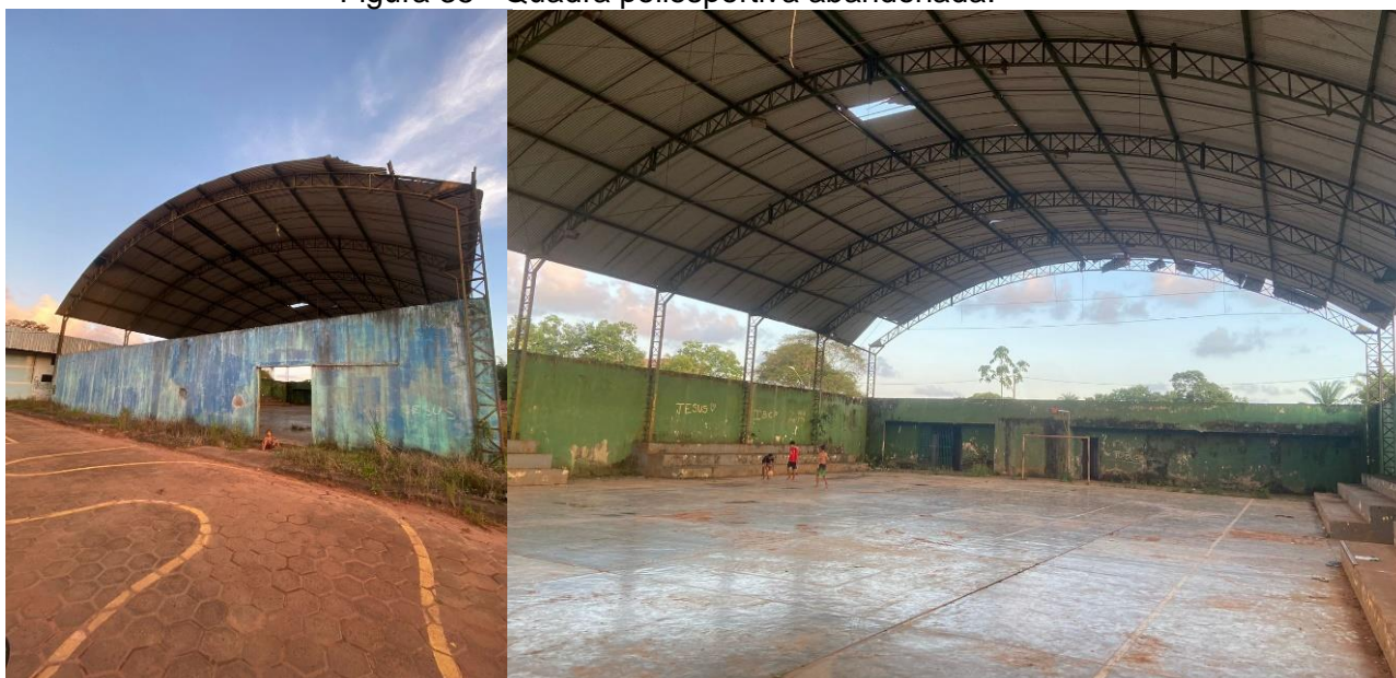
Figura 35 - Quadra poliesportiva abandonada.
