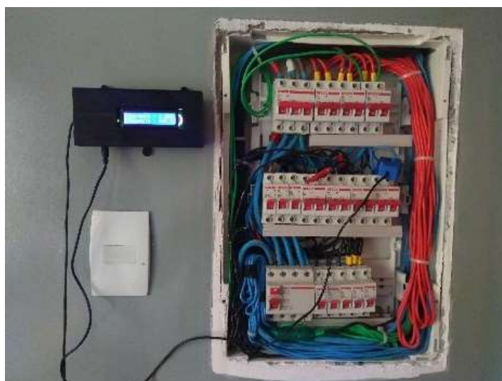
Figura 34 - Medidor instalado no painel elétrico
