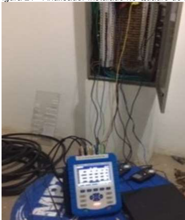
Figura 21 - Analisador Instalado no Quadro de Distribuição
