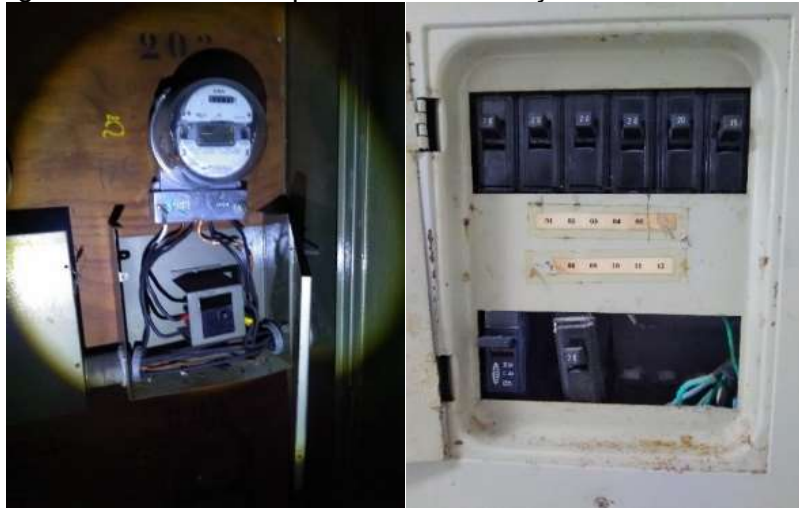
Figura 30 - Medidor e quadro de alimentação da unidade
