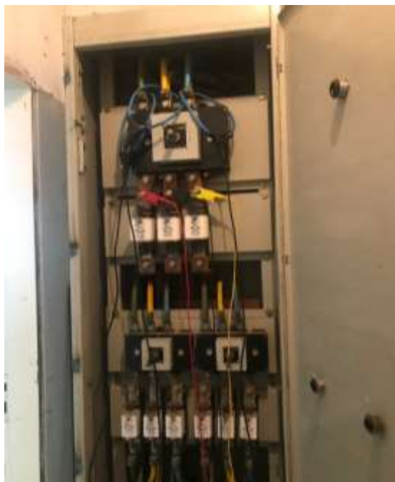
Figura 16 - Painel Geral de Baixa Tensão
