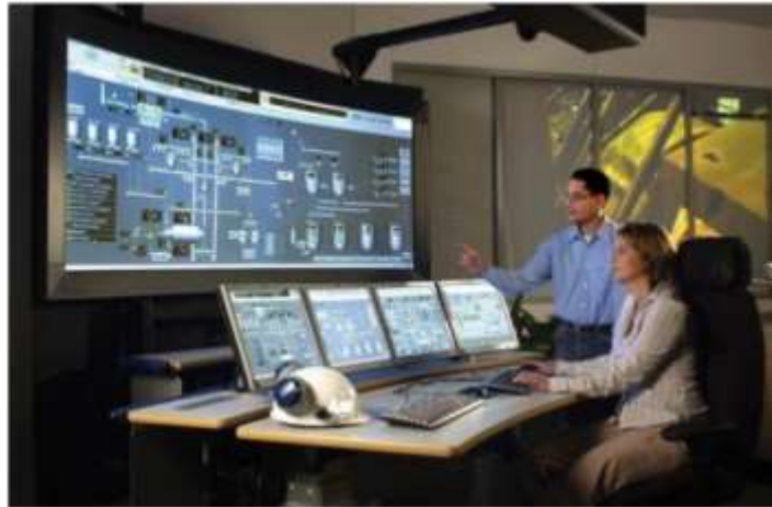
Figura 18 – Posto de operação do sistema SCADA em uma sala de controle
