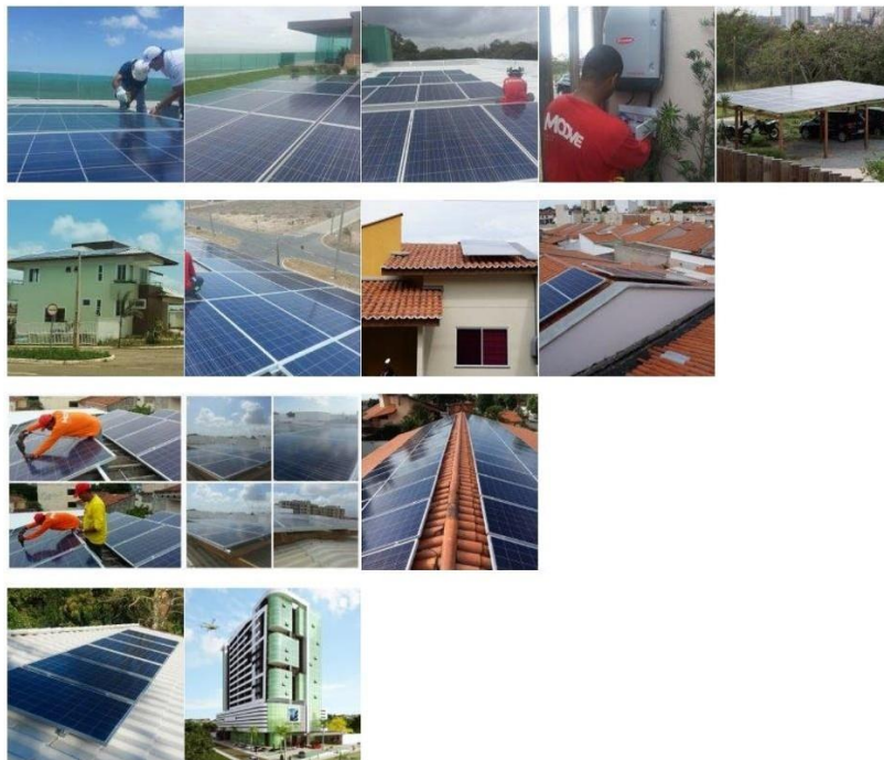
Instalações realizadas pela Moove Energia Solar
