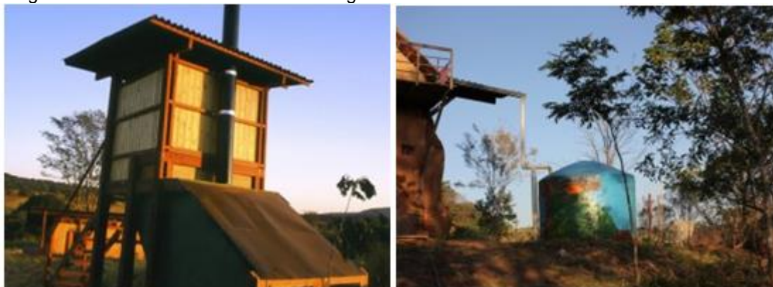
Figura 13 – Banheiro seco e coleta de água da chuva com cisterna
