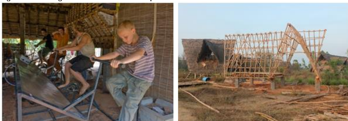
Figura 23 – Energia renovável e bioconstrução em Sadhana Forest
