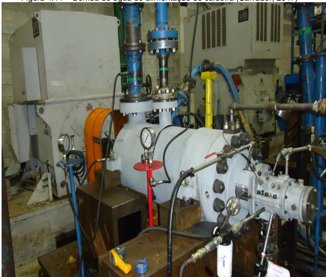
Figura 4.11 – Bomba de água de alimentação de caldeira (Salvador, 2017)
