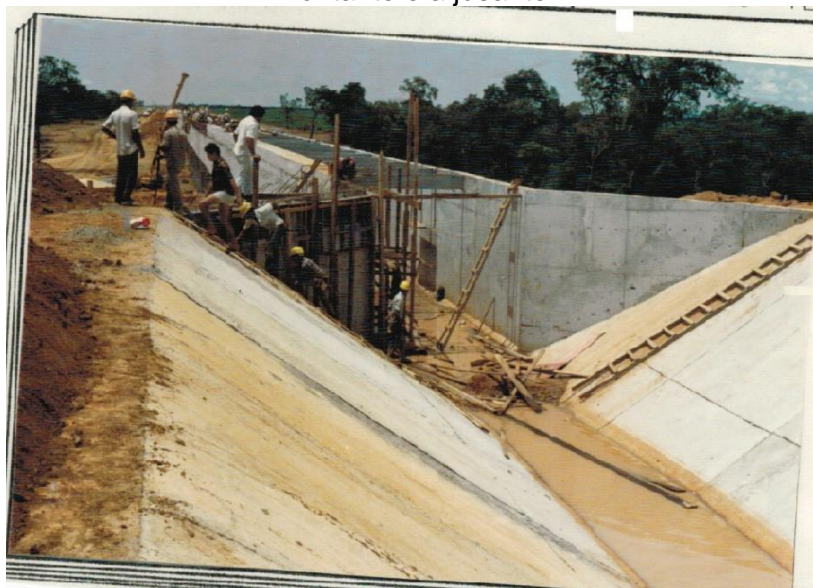
Figura 19 - Aqueduto - Complementação da calha e interligação com o canal principal à montante e a jusante
