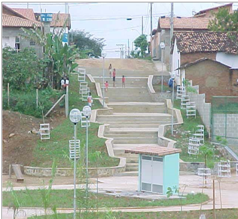
Figura 27 – Estação elevatória na área do Lava-Pés Fonte: Itapebi Geração de Energia S/A
