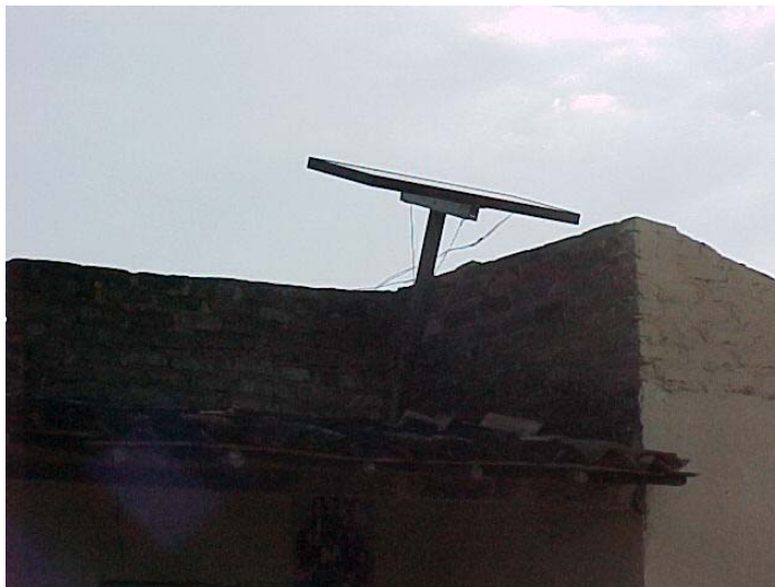
Estrutura precária sobre o telhado de uma residência
