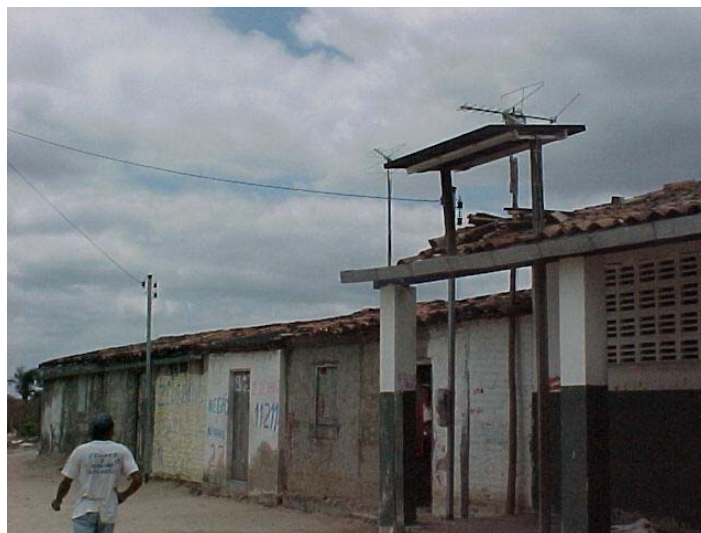
Painel com orientação incorreta
