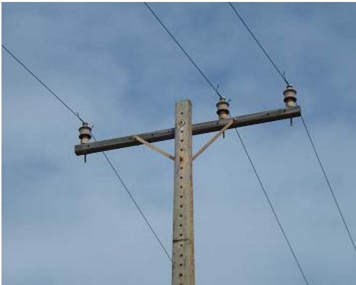
Figura 8 - Conductor primário de cobre nu Nota: Elaboração própria.
