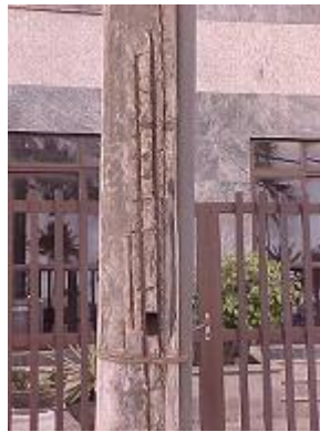
Figura 1 - Poste estragado devido à salinidade Nota: Elaboração própria.
