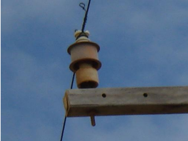
Figura 2 - Isolador híbrido – corrosão elevada Nota: Elaboração própria.
