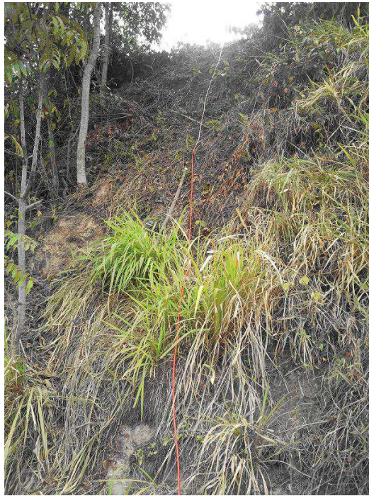
Figura 3.6 - Perigo na instalação de cabeamento em locais íngremes
