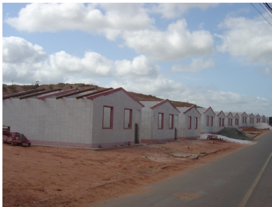
Figura 31 – Bairro da Piaçaveira: Construção de casas populares em 06/01/2006 Fonte: Pesquisa direta, autoria própria
