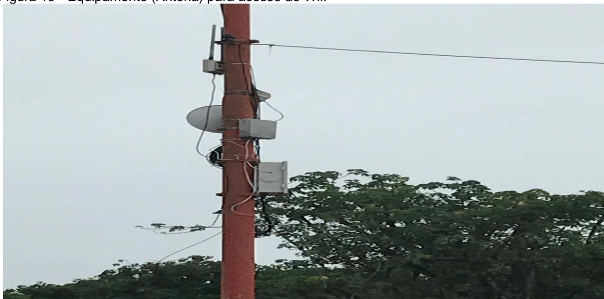
Figura 19 - Equipamento (Antena) para acesso ao Wifi
