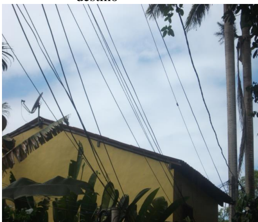
Figura 21 - Fiação aérea comprometendo a qualidade da malha urbana do destino
