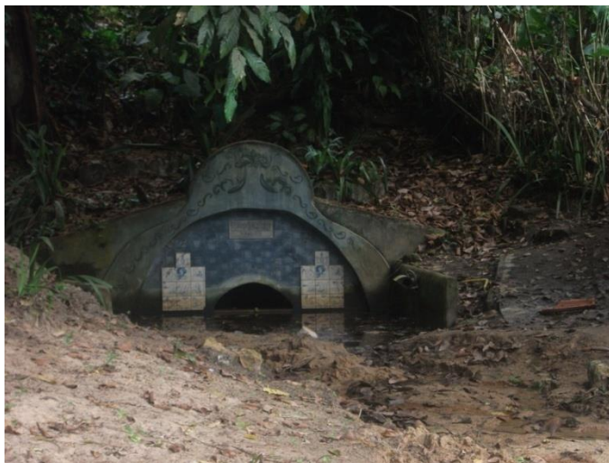
Figura 20 - Fonte da Biquinha nos dias atuais comprometida pelo assoreamento e contaminação do solo, em virtude da poluição
