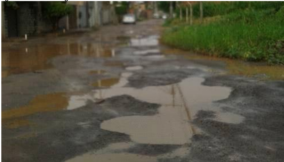
Figura 6 - Ruas Alagadas e Esburacadas
