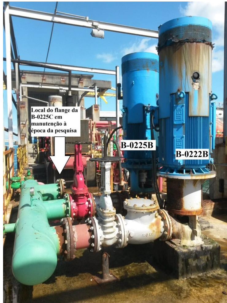
Figura 30 - Bombas de água salgada
