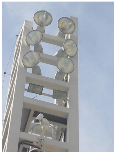
Figura 4.7 - Torres de Iluminação com lâmpadas de multivapores Metálicos de 1.000 W e halógenas de 1.500W
