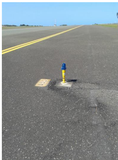
Figura 7.30 - Iluminação Pista de Taxiway com Luminária Específica LED
