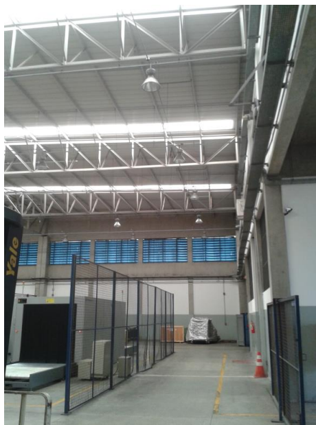
Figura 7.8 - 6 Iluminação TECA com Luminárias Industriais com lâmpadas de multivapores metálicos de 400W
