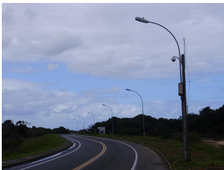
Figura 4.3 - Iluminação Pública de via de acesso com lâmpadas a vapor de sódio de 250W
