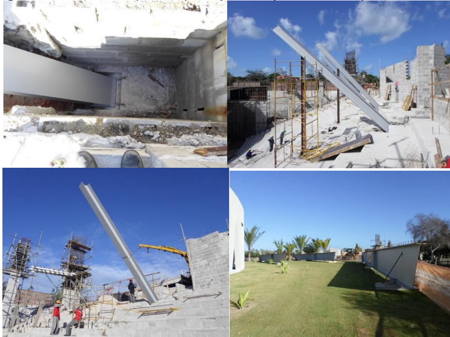
Figura 16 - Painel 5 – Mosaico apresentando: a) fundação para fixação da mão francesa; b) mãos francesas e detalhe das colunas laterais em concreto (suporte para fechamento perimetral); c) vigas inclinadas de suporte à pré-laje da arquibancada superior
