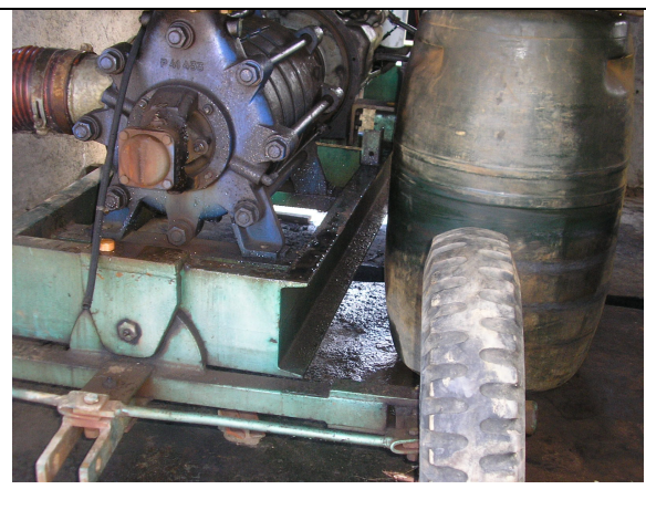
Foto 4 - Motor à Óleo Diesel às Margens da Barragem do Apertado com Vazamento
