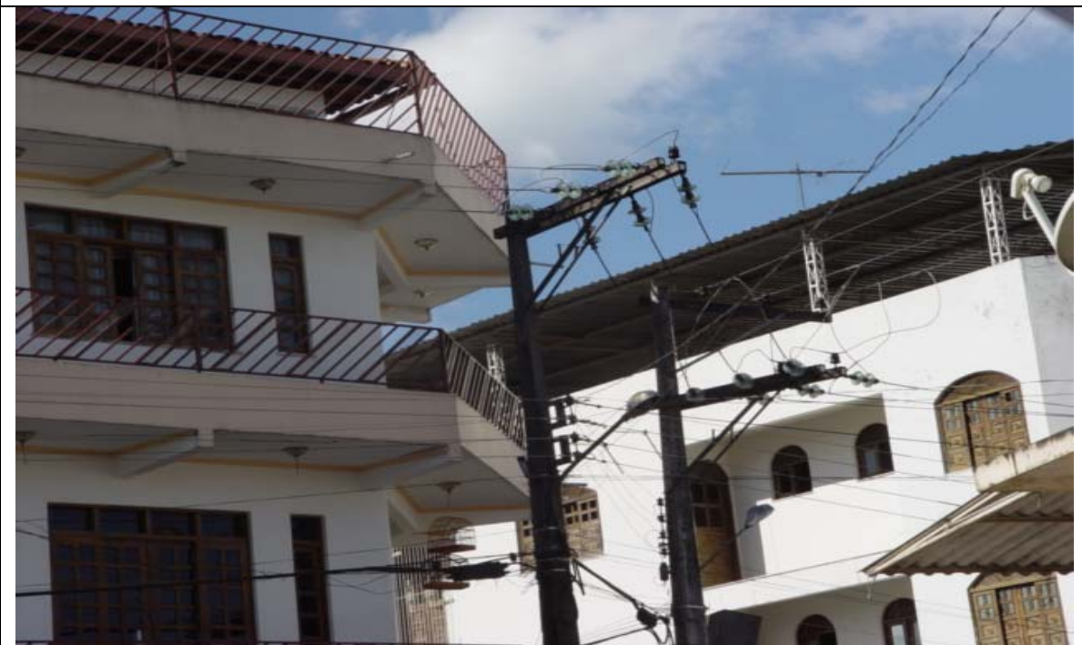
Figura 8: Rede primária perigosamente próxima à área de circulação. Fonte AGERBA. Relatório 2003.
