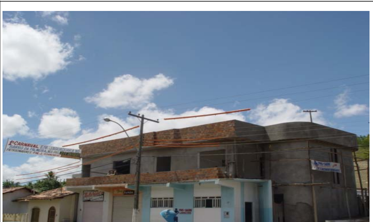
Figura 7: Linha convencional oferecendo risco de vida. Fonte relatório de fiscalização AGERBA 2003.
