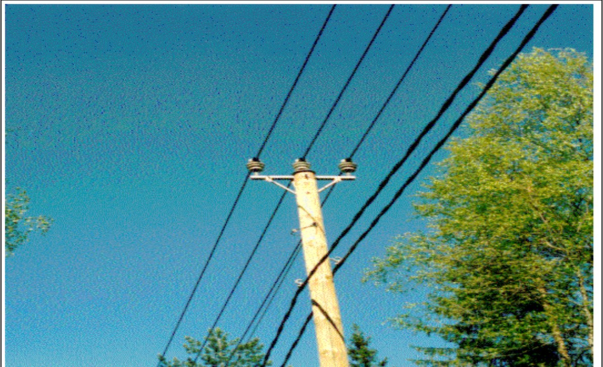
Figura 14: . Exemplo de área urbana com rede compacta usando braços. Fonte www.inbrac.com.br .
