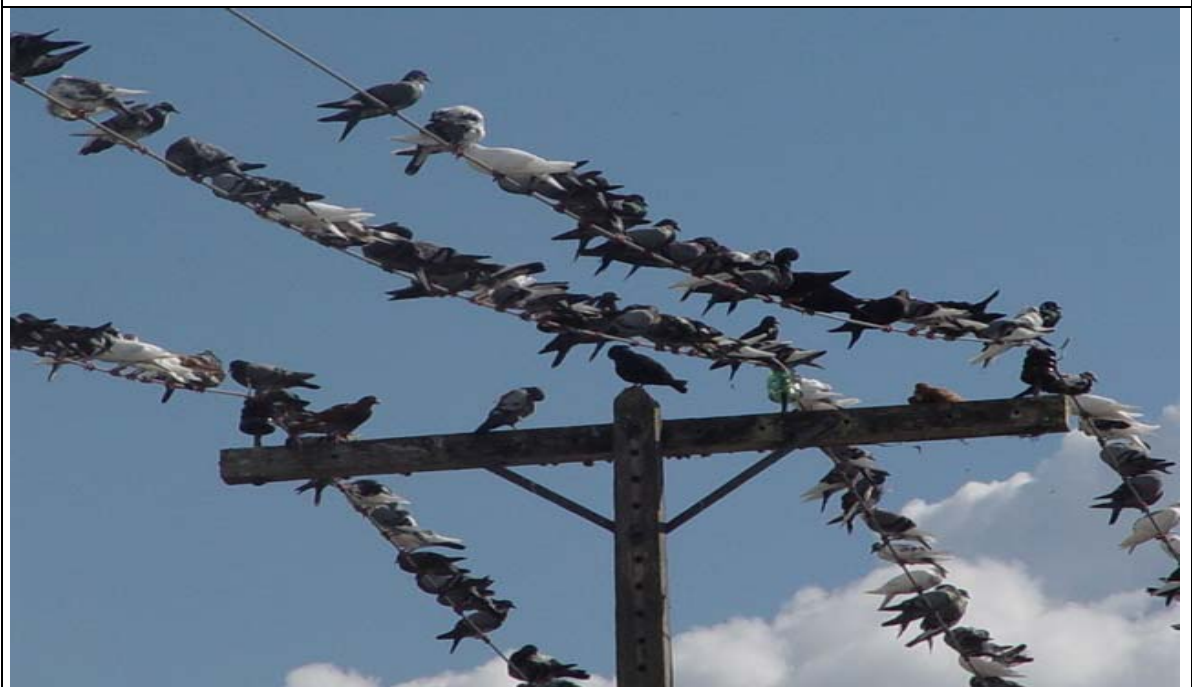
Figura 38: As redes convencionais sujeitas a intervenções inusitadas. Fonte relatório fiscalização AGERBA.
