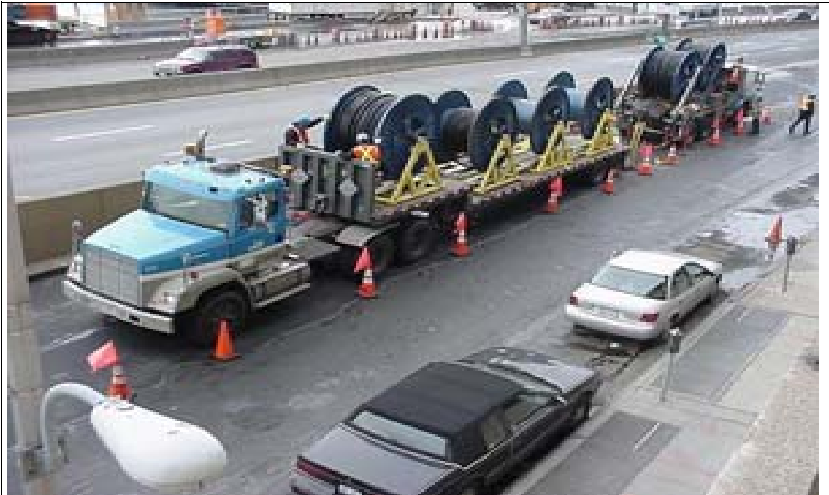
Figura 33: NY. 56.000 km de cabos subterrâneos fomentam uma indústria pesada. Fonte Co. Edison.
