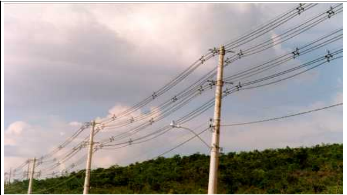
Figura 15: Saída de subestação com quatro alimentadores compactos. Fonte www.pirelli.com.br
