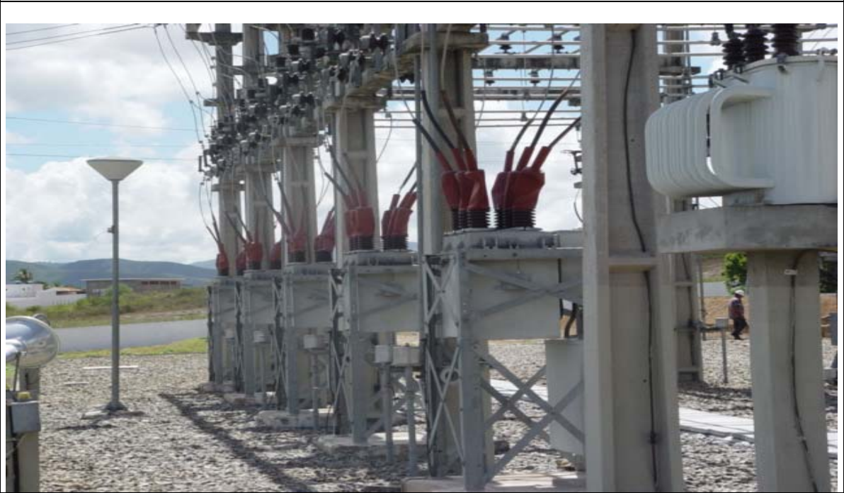
Figura 17: Disposição de religadores na saída da subestação. Fonte AGERBA. Relatório 2003.
