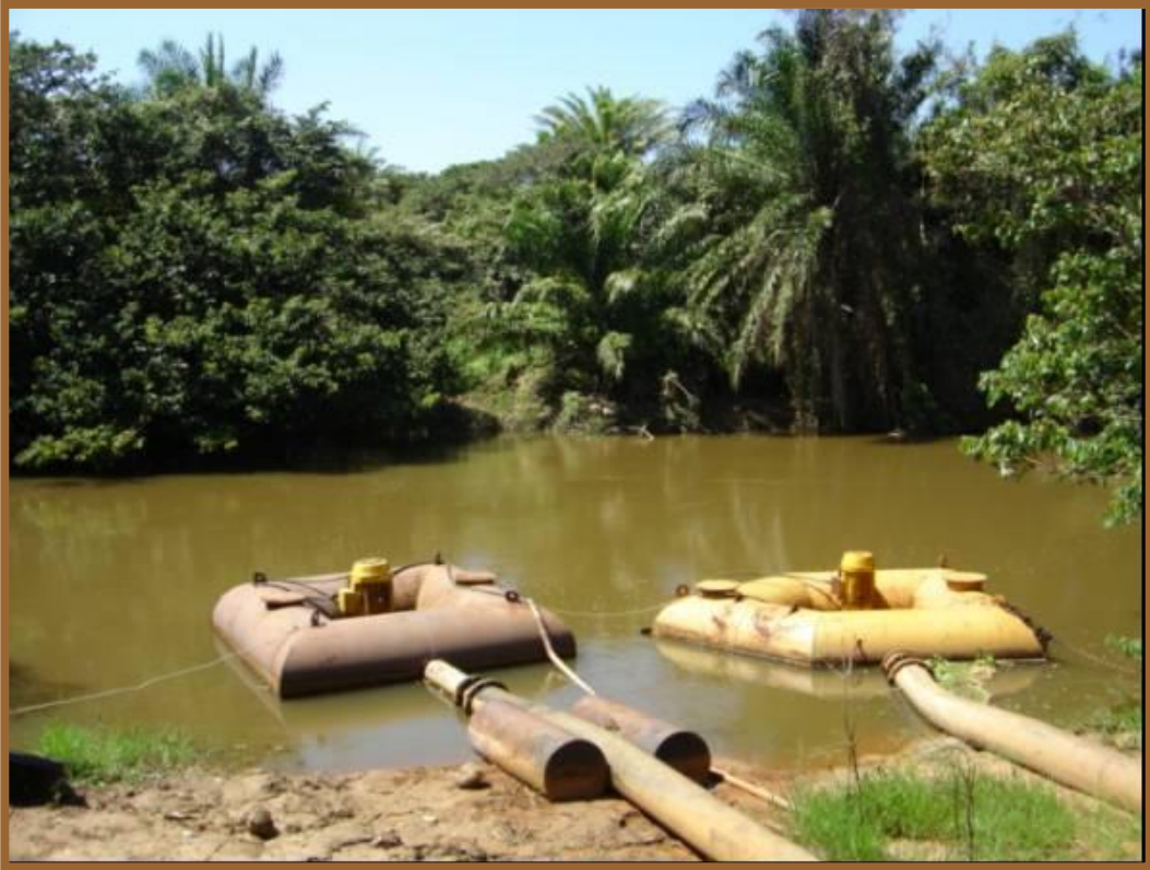
Figura 9 - Bombas de captação flutuante no Rio em Barra do Pojuca Foto: Denise Britto (2009).
