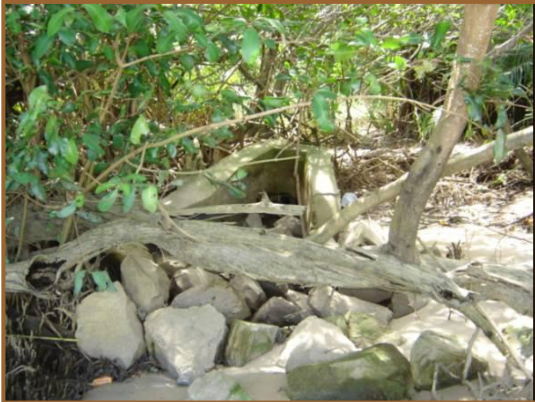
Figura 18 - Detalhe do ponto de lançamento dos efluentes tratados da ETE – Praia do Forte Foto: Denise Britto (2009).
