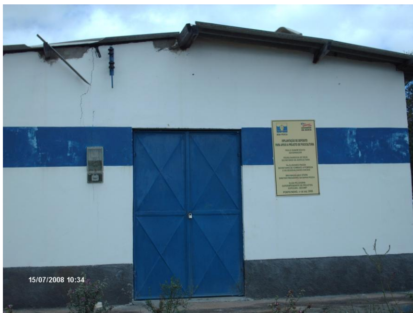
Figura 8.4 - Estrutura abandonada da piscicultura de Ponto Novo Nota: Visita de campo, julho 2008.
